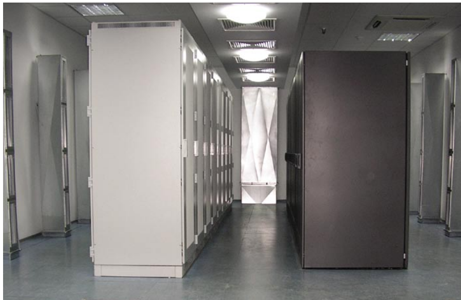
U glavnoj serverskoj sobi PORTUS-a nalazi se računalna oprema od 70-ak servera te mrežna interkonekcijska oprema
